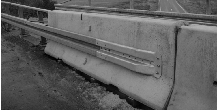
Figur 7.43 Eksempel på overgang mellem trafikværn og autoværn.!
